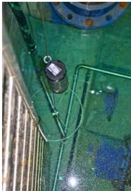
Jasně viditelné: Potrubí s CO 2 na dně čerpací nádrže
