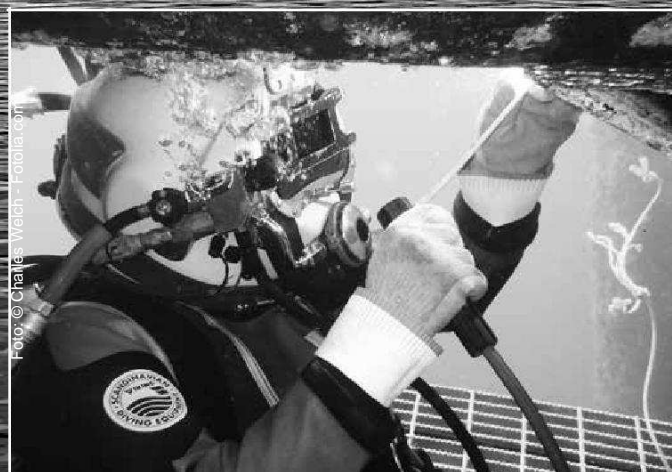
Zvaracie práce sú potrebné nielen pre novostavby, ale aj pre opravy jestvujúcich zariadení.
